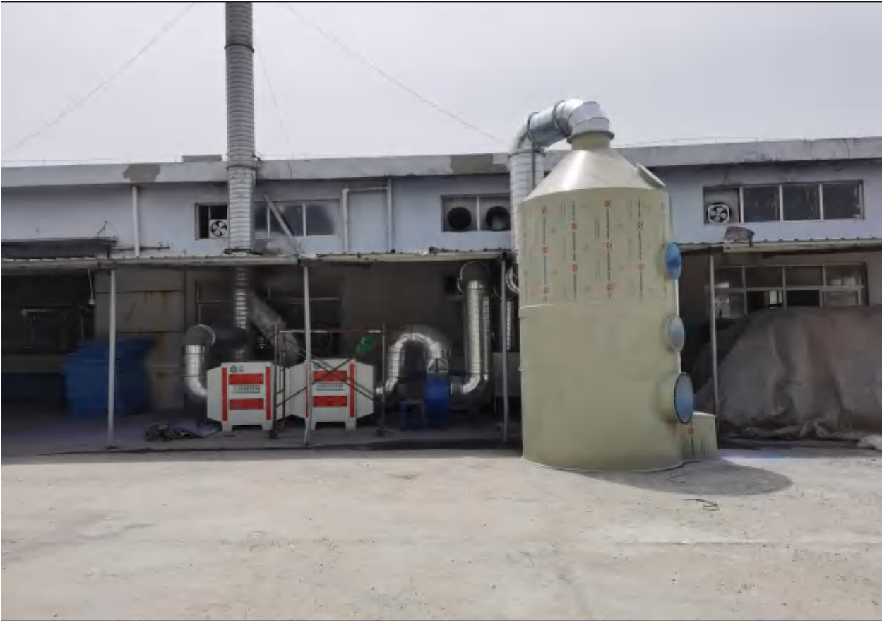
废气处理设施和废气排气筒
